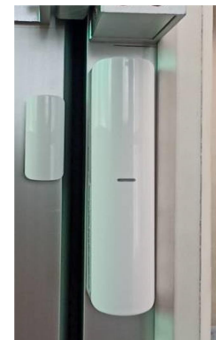
ตรวจจัดการ เข้าออกห้อง Data Center
