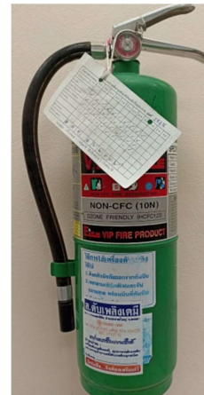
ถังดับเพลิง
