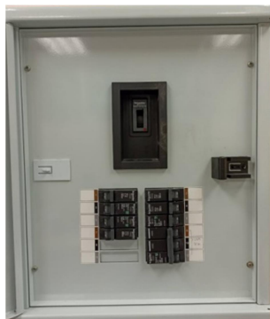
ตู้ควบคุมไฟฟ้า
